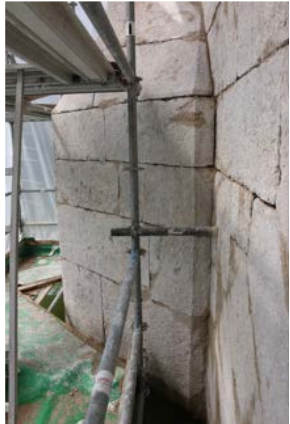
Abb. 82 stattdessen haben wir "Franselkanten" mit Flickmörtel ergänzt und dann die "beruhigten" Fugen ausgefugt.
