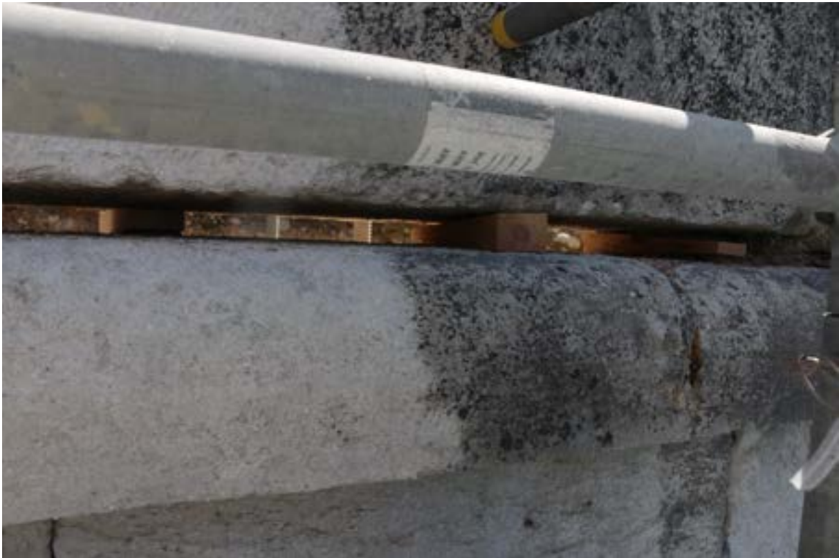
Abb. 45 Fugendurchsicht nach Entfernen der minimal ausgeführten Fugenfüllung
