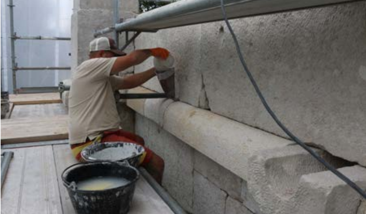
Abb. 80 im linken Bereich der rechten Brüstungsplatte zu erkennen: Bohrloch
