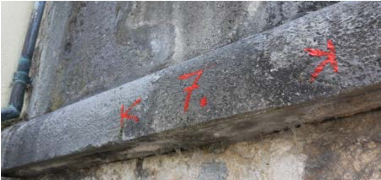
Abb. 66 alte Betonplombe, ohne Wassernase
