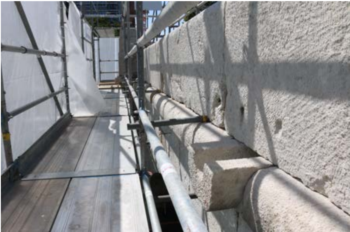
Abb. 13 Einige Brüstungsplatten weisen Bohrlöcher auf. Sie dienen der Aufnahme von Spaltkeilen und sind eigentlich Fehlbohrungen. Zum grossen Teil verlaufen sie von aussen unten nach oben innen. Das deutet darauf hin, dass der Stein im Bruch andersherum gelegen haben muss. Erstaunlich auch, dass zur Entstehungszeit der Brücke schon solche Bohrer existiert haben.
