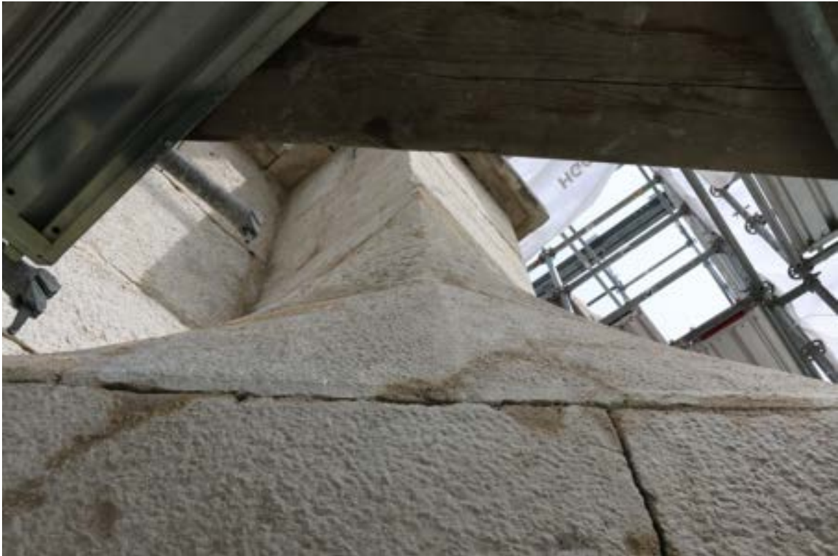
Abb. 91 Nach den Mörtelergänzungen wird der Bau wieder in seiner Plastizität erkennbar, und das bereits vor dem Ausfugen.
