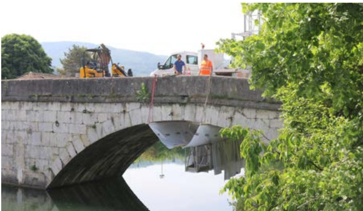
Abb. 7 oben bilden Vliesbahnen einen Trichter, unten ist der Arbeitskorb mit Vliesbahnen ausgekleidet.
