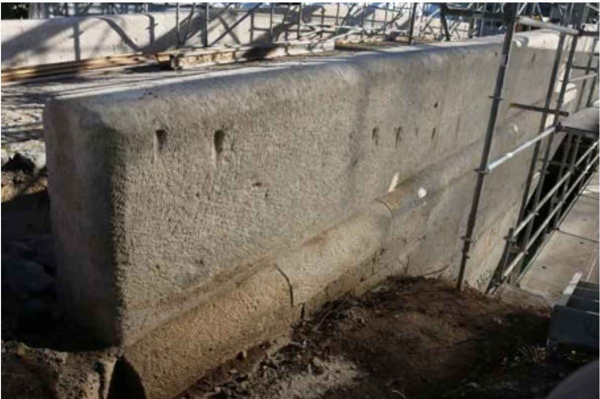
Abb. 31 im Streiflicht gut zu erkennen: Bohrlöcher, die in die fertige Oberfläche der Brüstung reichen.
