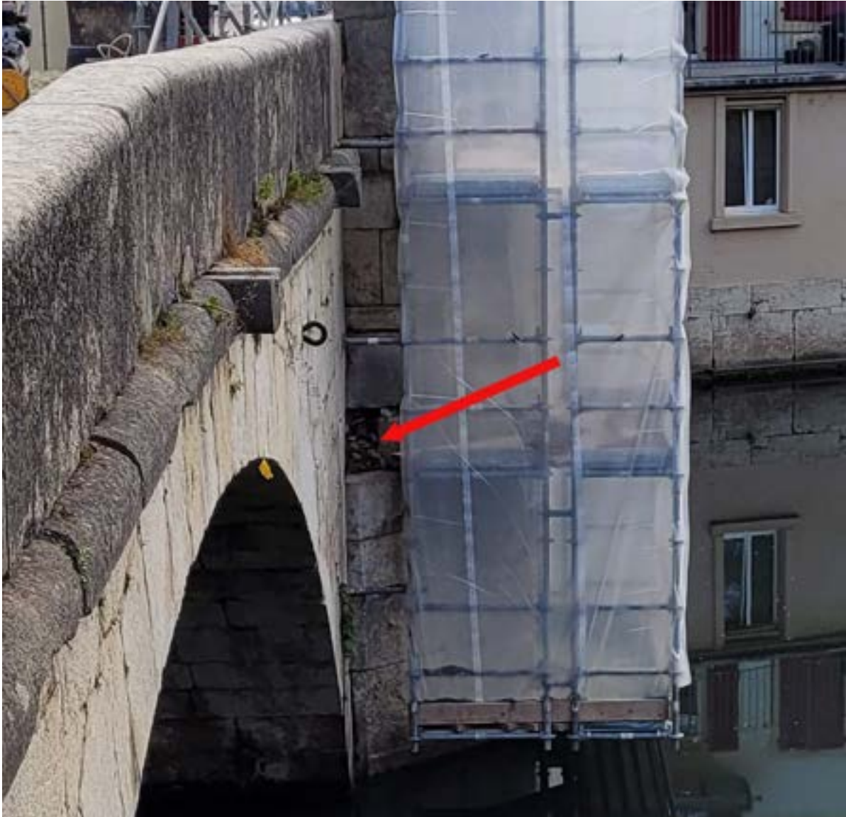
Abb. 39 Ein Stein ist mehrere Zentimeter nach aussen geschoben. Der rote Pfeil weist auf den Standort.
