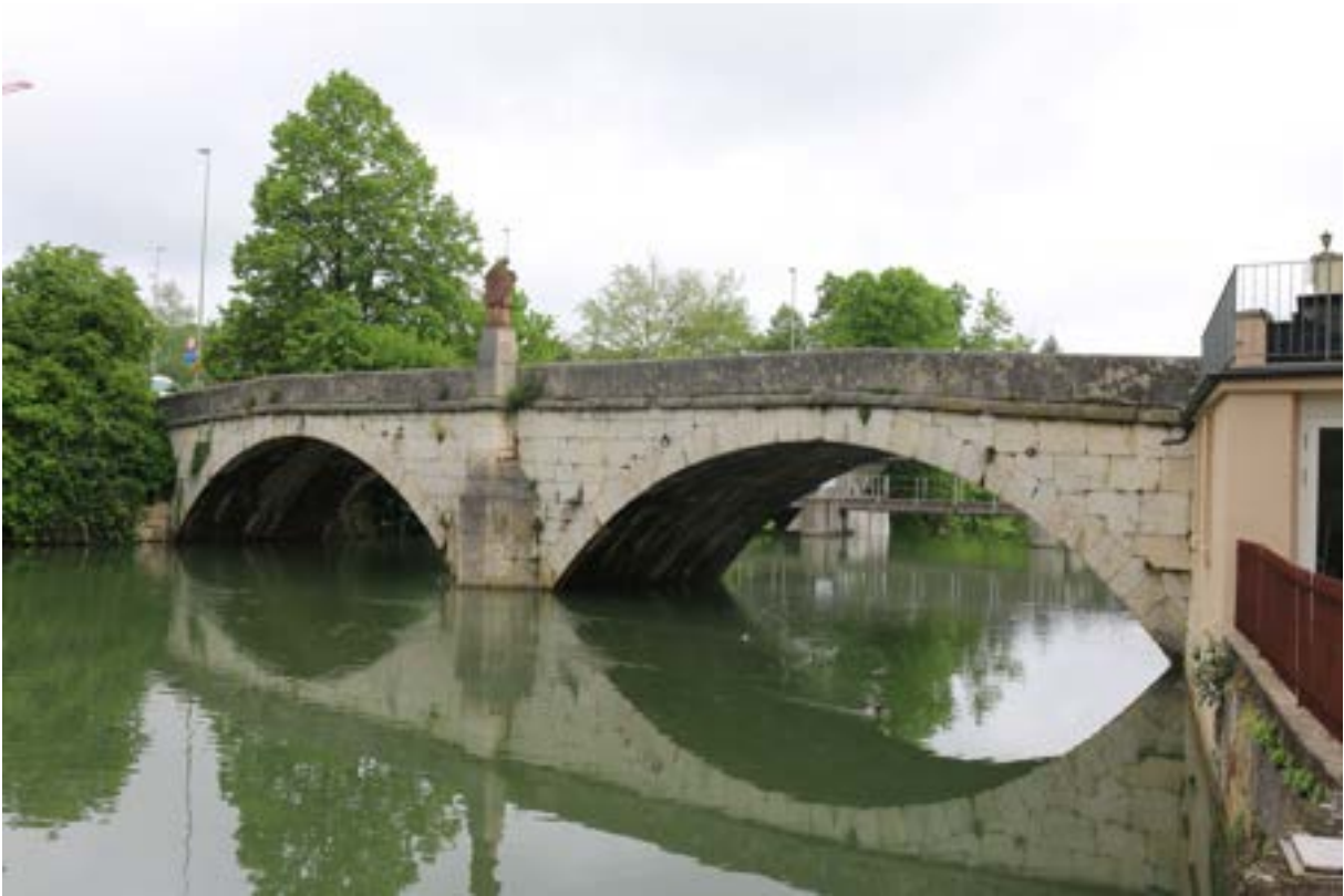
Abb. 3 Rückseite, Mai 2023, Zustand vor den Sanierungsmassnahmen
