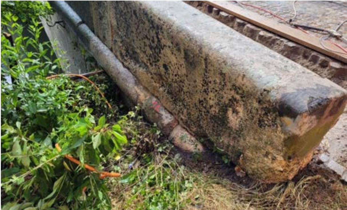
Abb. 77 Reinacherseite, flussab, halb von Erdreich überdeckt
