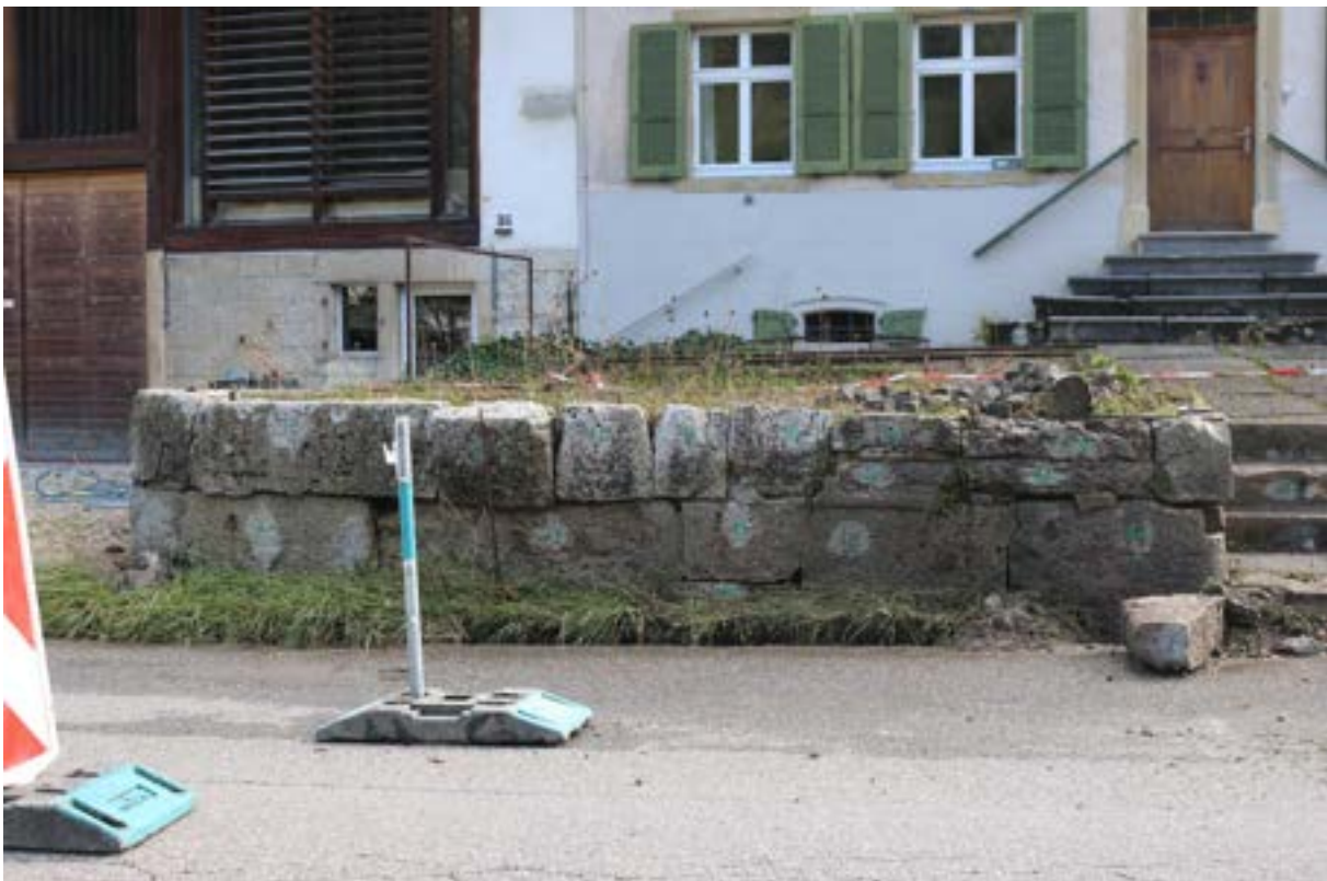
Abb. 6 Vor dem Abbau wird die Mauer heiss abgedampft und anschliessend nummeriert und fotografiert. Die Radabweiser (einer rechts im Bild) werden nicht wieder montiert.
