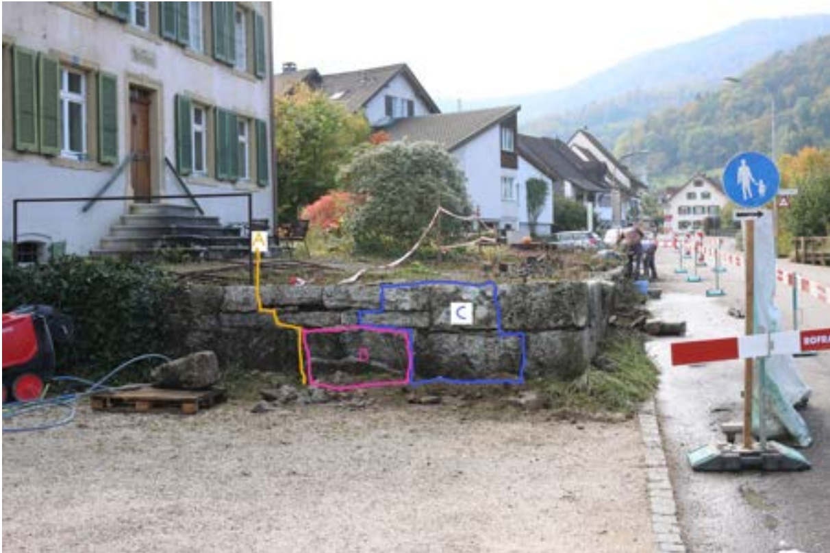
Abb. 7 Die strassenseitige Mauer wird entfernt und etwa 2,5 Meter weiter links wieder versetzt. Bis zur gelben Linie A wird die Mauer abgebaut. Stein B hat keine bearbeitete Oberfläche und ist nur ein paar Zentimeter dick. Er wird aussortiert. Partie C wird auf der Strassenseite zur Ergänzung verwendet.
