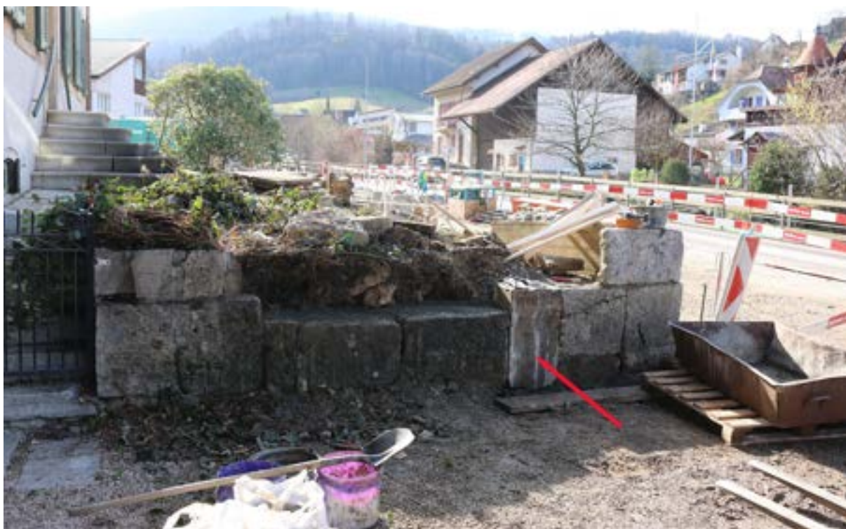
Abb. 17 Die Mauerecke Parkplatz/Strassenseite ist hier bereits wieder aufgebaut. Die oben erwähnten beiden Steinreihen sind entfernt. Der mit rotem Pfeil bezeichnete Stein füllt die Lücke zwischen stehengelassener Mauer und der nach links versetzten, wiedererrichteten Mauerecke.
