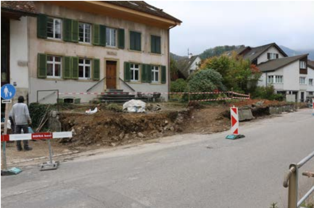
Abb. 12 Nach dem Abbau der Mauer. Rechts im Bild ist die Betonmauer erkennbar. Eisenteile haben teilweise durch Rostsprengung Steine beschädigt und werden ausgebohrt. Nur ein paar Ringe an den Vorderseiten werden, weil ohne Schäden, und weil sie Geschichte erzählen, belassen.
