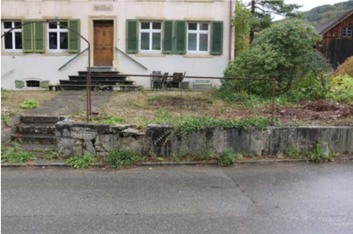
Abb. 5 Rechts im Bild beginnt die Betonmauer und reicht bis zum Wollbächli. Vor Beginn der Arbeiten war nicht klar, ob es sich um Beton handelt, oder verputzten Naturstein. Während des Abbruchs zeigt sich, dass dieser Mauerbereich durchgehend aus Beton besteht.
